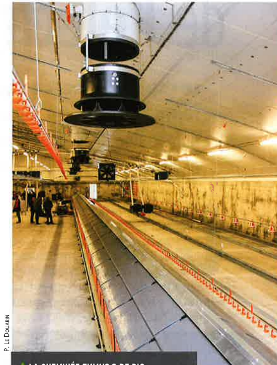
▲ LA CHEMINÉE FUMUS 2 DE BIG DUTCHMAN permet de travailler sur une grande largeur avec une dépression très faible. Elle peut être utilisée en élevage plein air (poules en volière notamment) en position centrale.
