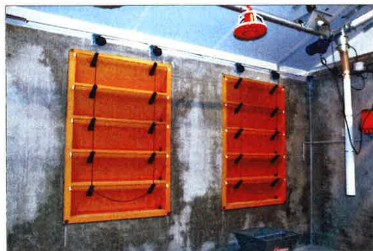
▲ Des jalousies sont situées de part et d'autre du bâtiment afin de réguler la température de l'air en été quand la chaleur est trop importante. Le reste de l'année, un système de chauffage au gaz permet de maintenir une température de 20 °C dans l'ensemble du bâtiment.
