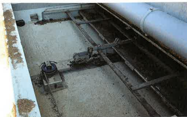
Le racleur est relié à câble, lui-même actionné par le moteur.
